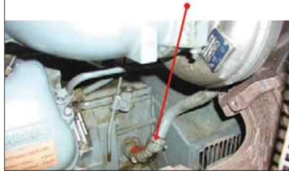
Bild 12: Thermisch überlastete Schmierölleitung
