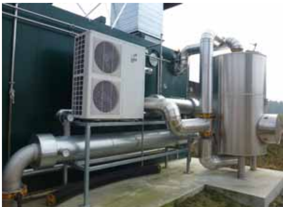
Bild 10: Gaskühlung und Gastrocknung
