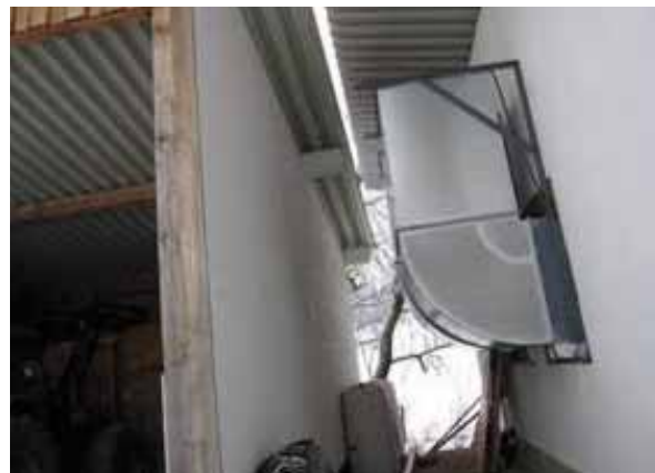
Bild 23: Unzureichende brandschutztechnische Trennung wegen ungeschützter Lüftungsdurchführung (ohne Brandschutzklappe)
