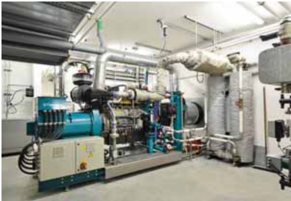
Bild 11: BHKW in Maschinenaufstellraum
