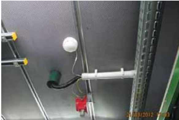
Bild 17: Rauch- und Gaswarnmelder
