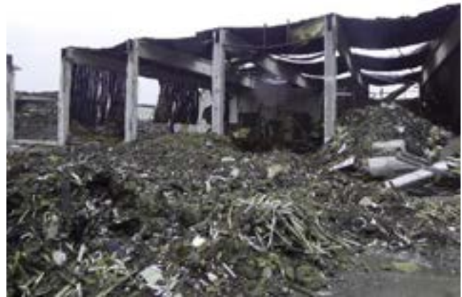
Zerstörungen an Dach und Gebäudeinhalt (Quelle: A. Issel)
