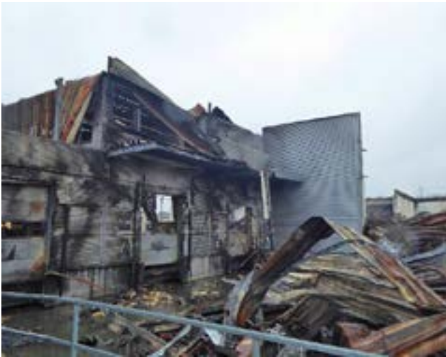
Die beschädigte Trennwand (Quelle: A. Issel)
