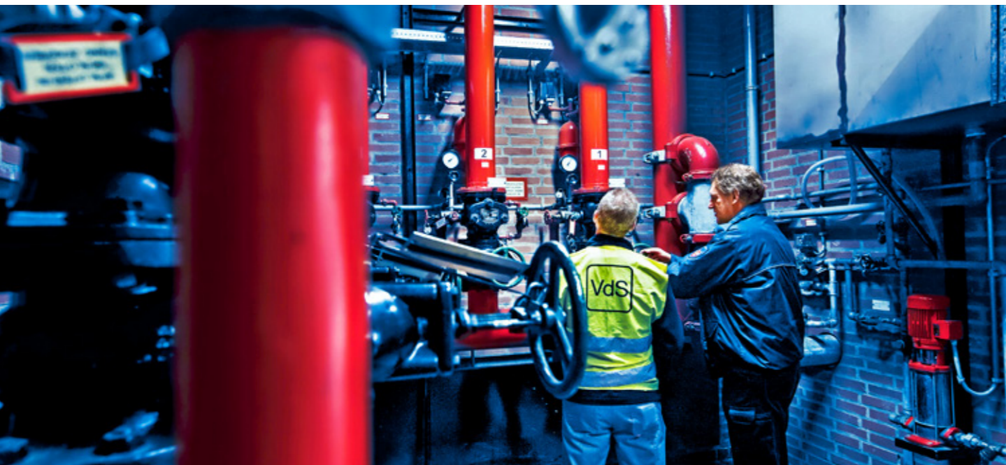
VdS-Prüfung von Löschanlagen vor Ort
