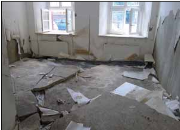
Abb. 8: Fehlende Auftriebssicherheit einer Fußbodenkonstruktion in einem überfluteten Wohngebäude führte zum Aufschwimmen und damit zu erheblichen strukturellen Schäden (© HTW Dresden)
